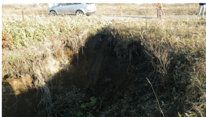
写真② 谷頭の状況 道路と谷頭がつながっており、土砂流出が生じている。
